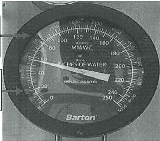
รูปภาพแสดงเกจวัดปริมาณของเหลวในถังบรรจุก๊าซออกซิเจนเหลว
